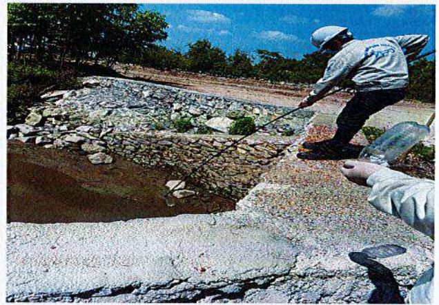
Hình PL 2: Cửa xả nước thải chảy tràn phía Tây Bắc Cảng xuất
